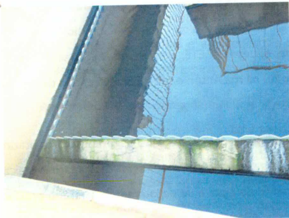
Foto 1. Áreas secas no vertedouro do reator, indicando desnível.
