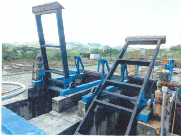
Foto 3. Equipamento de limpeza mecanizada fora de operação.
