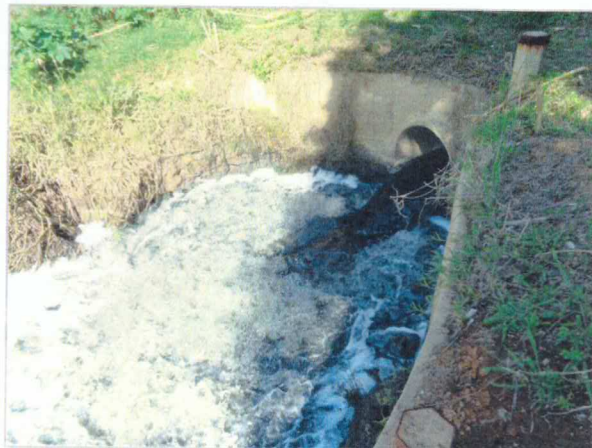
Foto 5. Ponto de lançamento de efluente tratado da ETE Sapucaí Mirim
