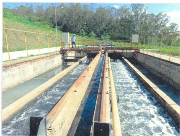
Foto 2. Estação de Tratamento de Esgoto Sapucaí Mirim – Tratamento preliminar
