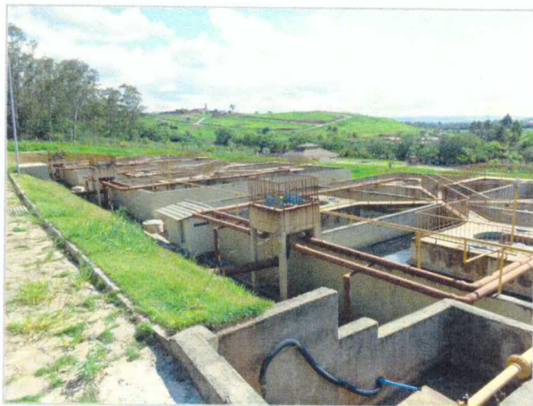
Foto 1. Estação de Tratamento de Esgoto Sapucaí Mirim – Reatores UASB
