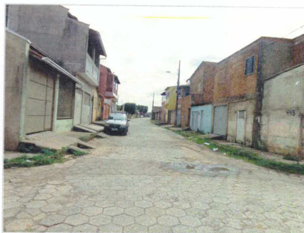
Foto 16. R. Oscar Dantas – Ausência de rede de drenagem
