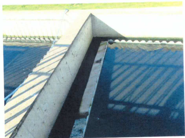
Foto 2. Áreas secas no vertedouro do reator, indicando desnível.
