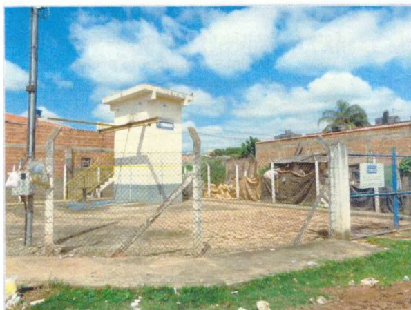
Foto 9. Estação elevatória de esgoto Massafera
