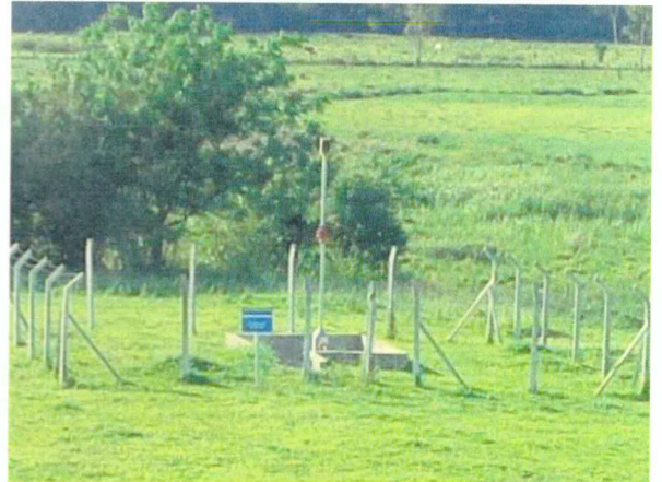
Foto 4. Queimador de gás fora de operação
