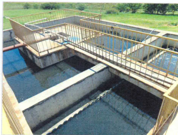
Foto 4. Estação de Tratamento de Esgoto Cidade Jardim – Reator UASB
