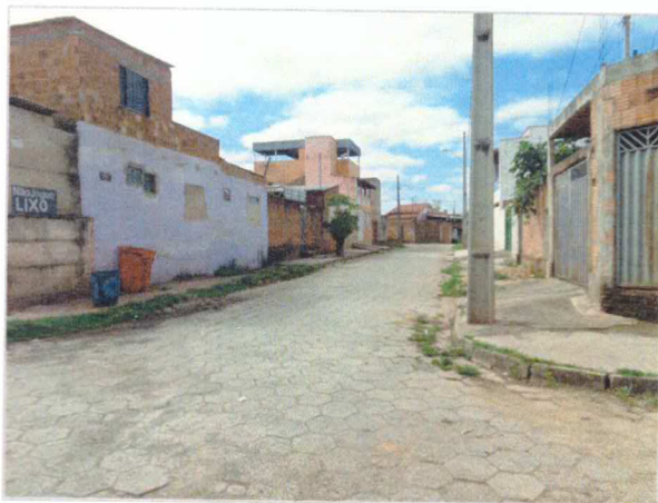
Foto 15. R. José Vicente de Paula – Ausência de rede de drenagem
