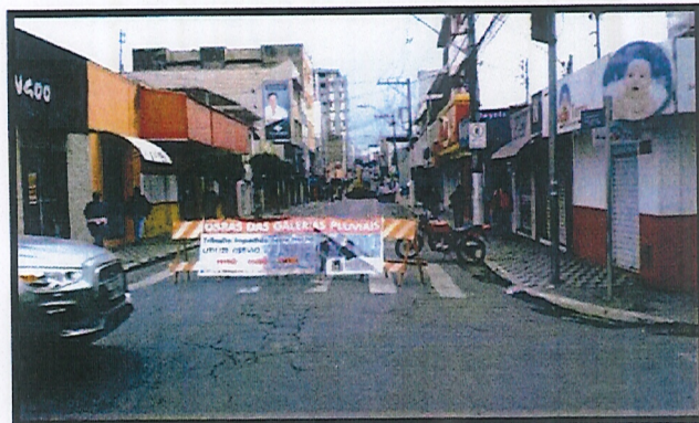
No dia 07/07/2015, a Rua Comendador José Garcia foi interditada para início das obras da Galeria Primavera.
