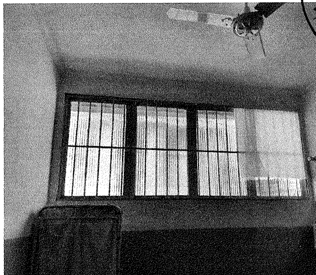
Figura 11 – Falta de trinco nas janelas.
