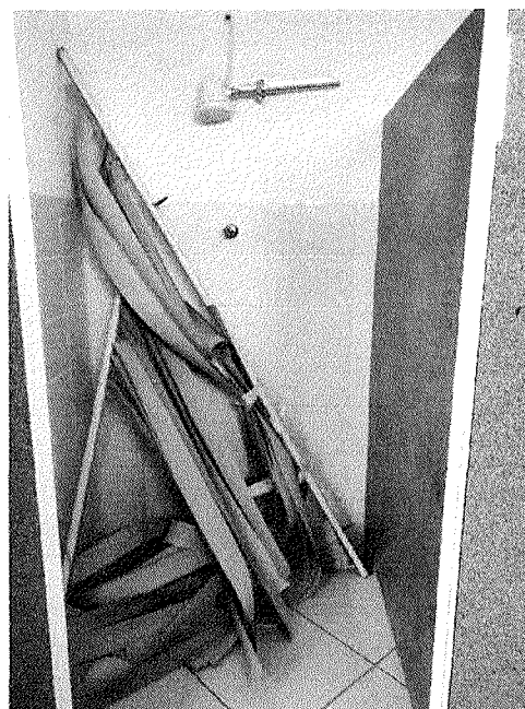
Figura 25 – Falta de porta na cabine do chuveiro do banheiro masculino.
