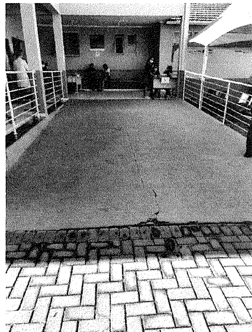
Figura 9 – Rachadura na rampa de entrada na UBS.
