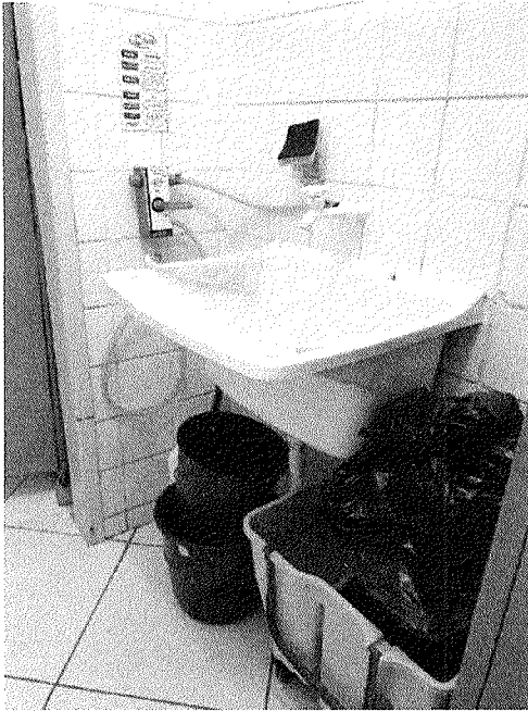
Figura 18 – Tanque do DML com sifão ruim.
