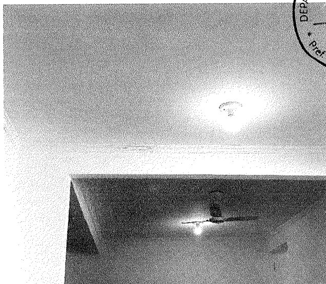
Figura 23 – Descolamento da camada de pintura devido a possíveis infiltrações.
