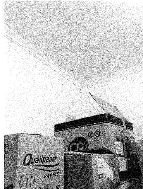
Figura 29 – Trinca na parede do almoxarifado.
