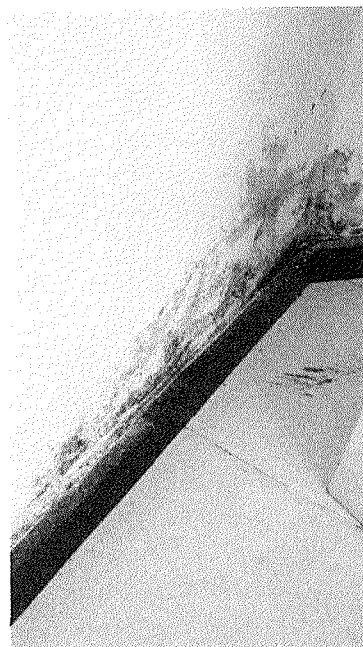
Figura 9 – Umidade na parede da sala de psicoterapêuticos.
