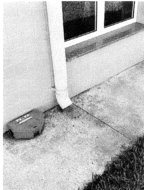
Figura 31 – Trinca no piso externo da UPA.
