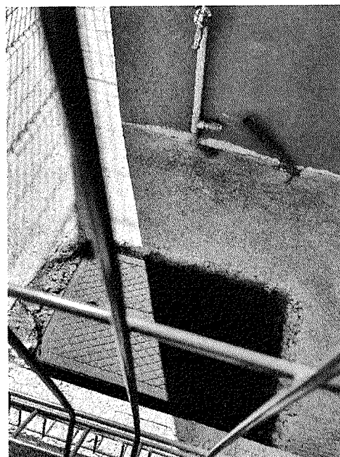
Figura 34 – Falta de acabamento na caixa telefônica.
