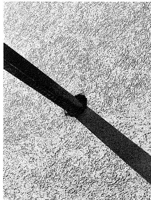
Figura 27 – Falta de acabamento na tubulação do gerador.
