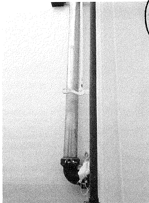
Figura 11 – Tubulação de hidrante sem a pintura correta.
