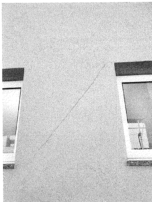
Figura 33 – Trinca na parede da área externa.
