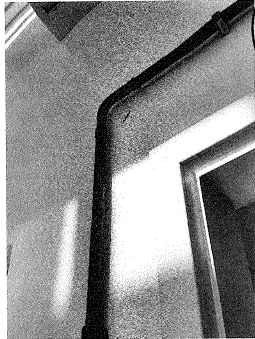
Figura 15 – Deslocamento de pintura.
