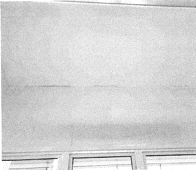
Figura 14 – Falta de acabamento na sala de utilidades.
