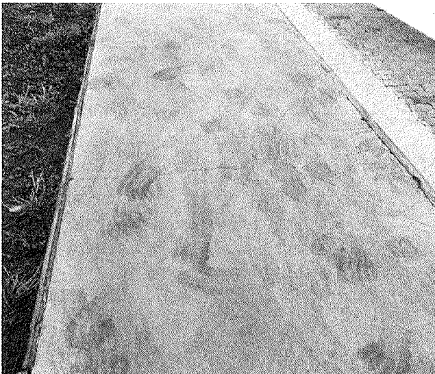
Figura 30 – Trinca no piso externo da UPA.
