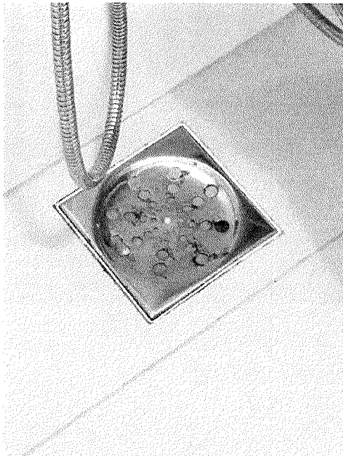
Figura 8 – Ralo com ferrugem no banheiro do quarto masculino.
