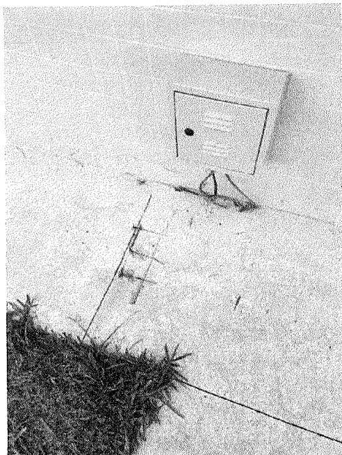
Figura 31 – Malha aparente no piso do corredor externo da UPA.
