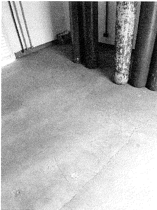
Figura 26 – Trinca no piso da sala de oxigênio.
