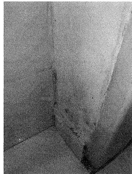
Figura 9 – Infiltração na parte inferior da parede do consultório.
