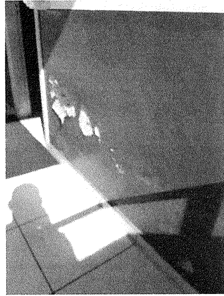
Figura 11 – Descascamento da pintura na parte externa da UBS.
