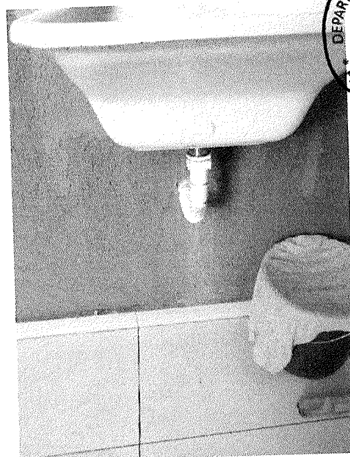
Figura 11 – Infiltração abaixo do tanque da área de serviço.
