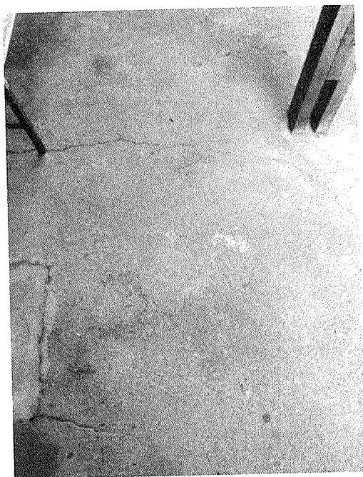
Figura 16 – Trincas no piso da área externa.
