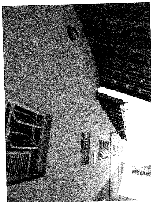
Figura 17 – Lâmpadas da área externa queimadas.
