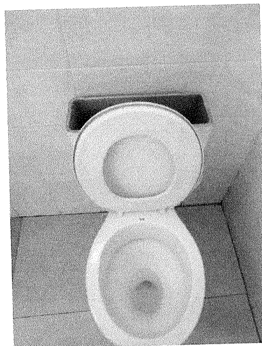
Figura 13 – Problema com caixa de descarga da bacia sanitária do banheiro da sala dos agentes de saúde.
