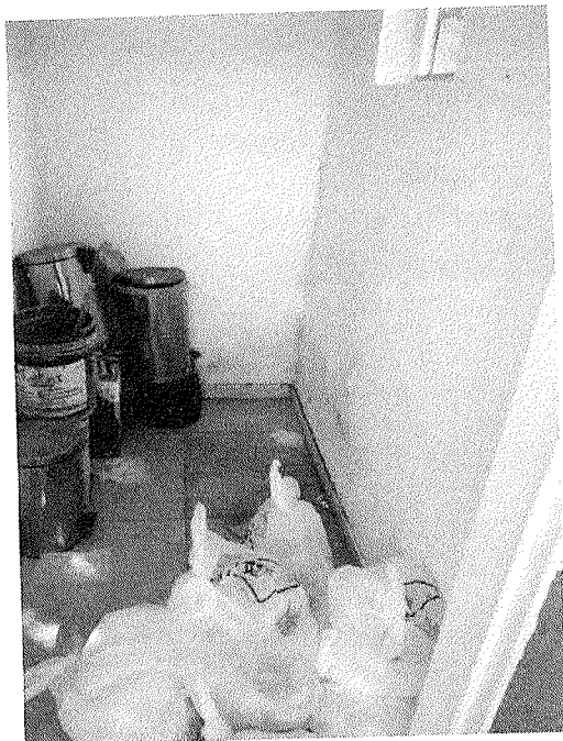
Figura 14 – Infiltração na parede interna da casinha de lixo hospitalar.
