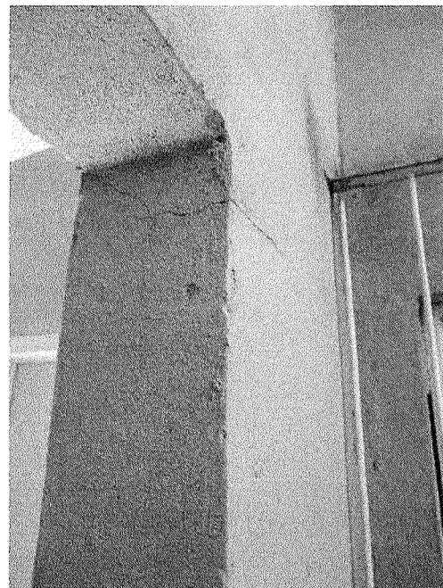
Figura 5 – Trinca no portal do corredor de acesso a sala de Vacinas.
