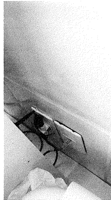
Figura 11 – Problemas elétricos na sala de curativos
