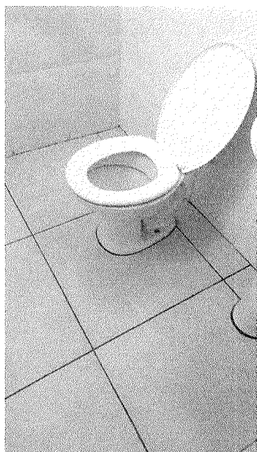
Figura 4 – Danos na tubulação de esgoto
