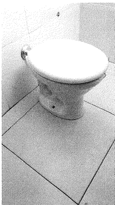
Figura 2 – Vazamento na bacia sanitária no banheiro dos funcionários
