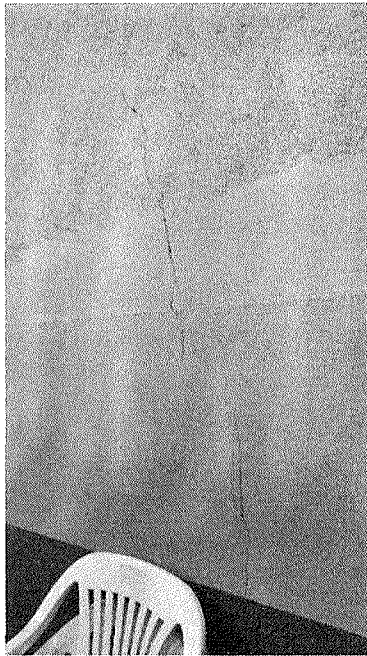
Figura 14 – Trinca no corredor
