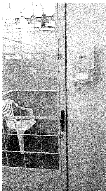
Figura 5 – Porta fora do esquadro na sala de vacinação
