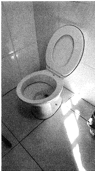
Figura 10 – Vazamento na bacia sanitária no banheiro da sala de enfermagem
