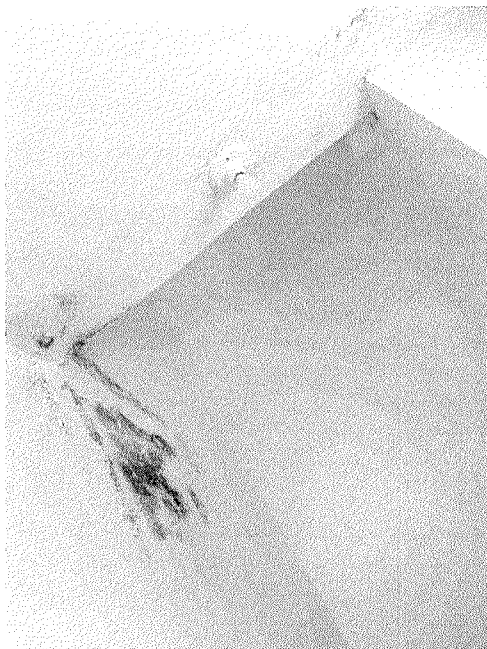
Figura 4- Mofo no teto do DML
