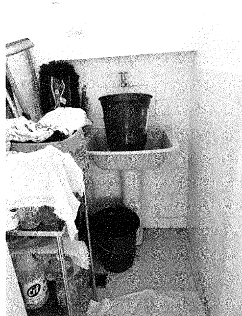
Figura 13 – Problemas no encanamento do tanque
