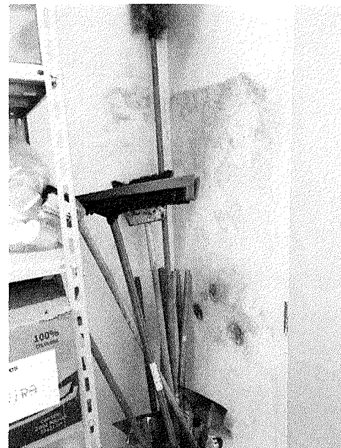
Figura 5 – Mofo nas paredes do almoxarifado
