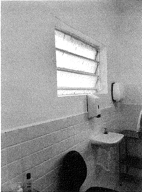
Figura 6 – Janela danificada no consultório
