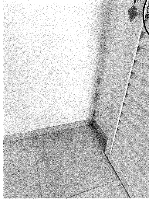
Figura 19 – Mofo nas paredes
