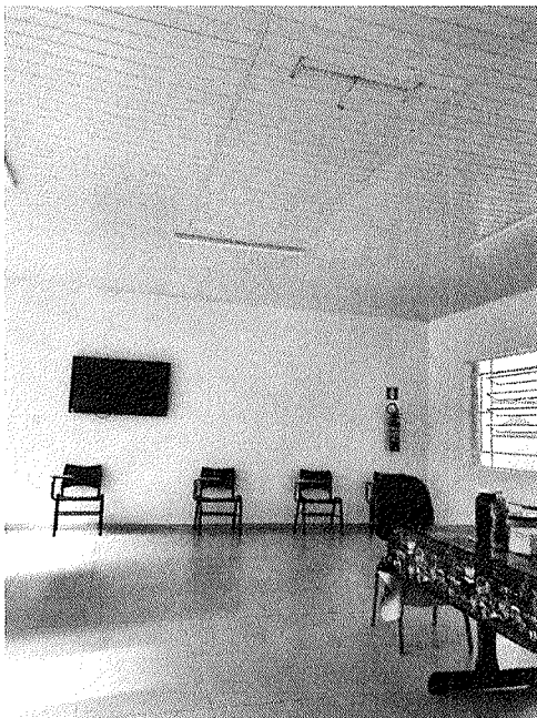
Figura 16 – Salão com infiltração através de pontos elétricos
