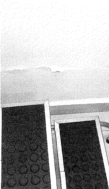
Figura 2 – Umidade no consultório 1
