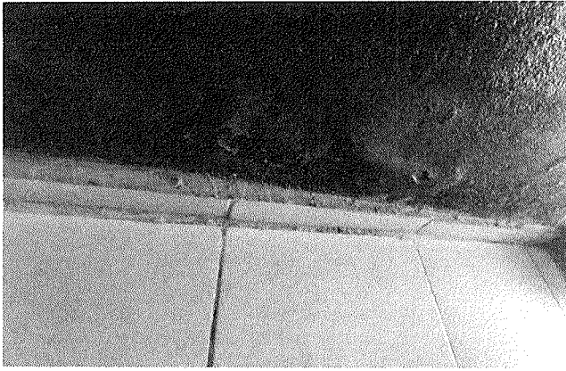
Figura 16 – Estufamento na parede
