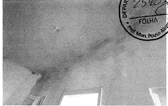
Figura 9 – Umidade nas paredes e danificação da pintura
