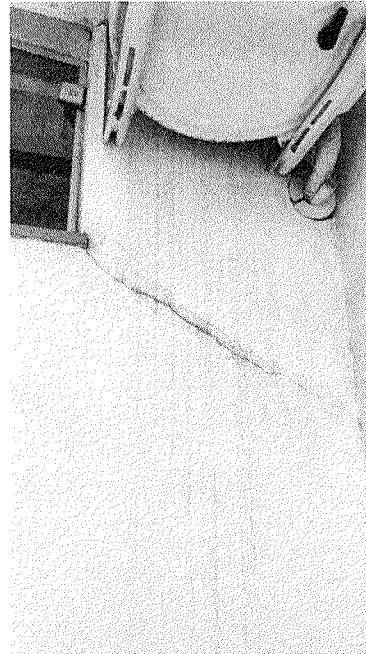
Figura 3 – Trinca de 45° no peitoril
