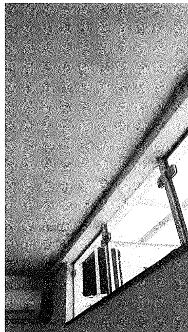
Figura 5 – Infiltração na laje-Sala de curativos
