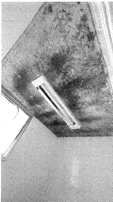
Figura 26 – Infiltração no banheiro para deficientes
