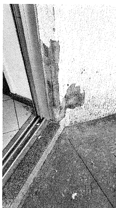
Figura 5 – Danos no acabamento
