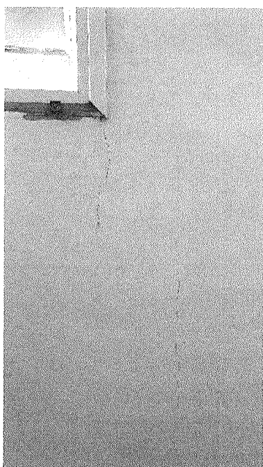
Figura 4 – Trincas nas extremidades das janelas, encontradas na maioria das salas
