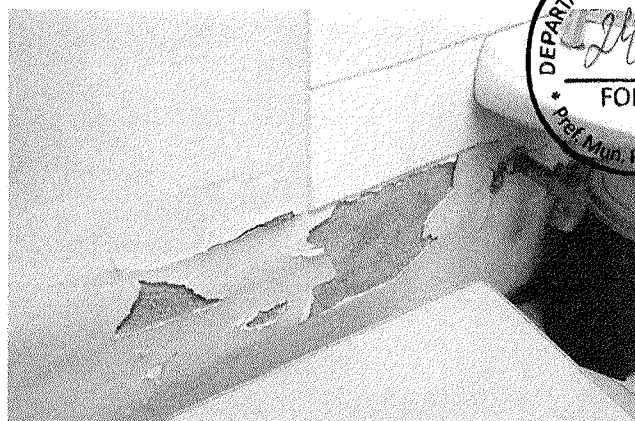
Figura 3 – Umidade em vários pontos da edificação
