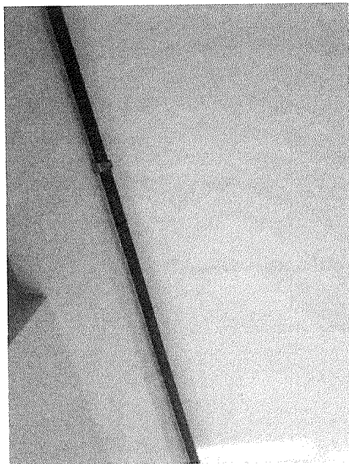
Figura 4- Trinca na laje
