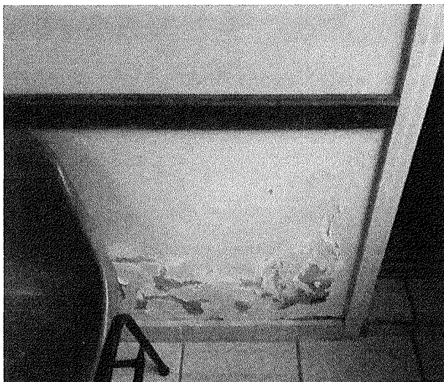
Figura 30 – Infiltração e danificação do acabamento
