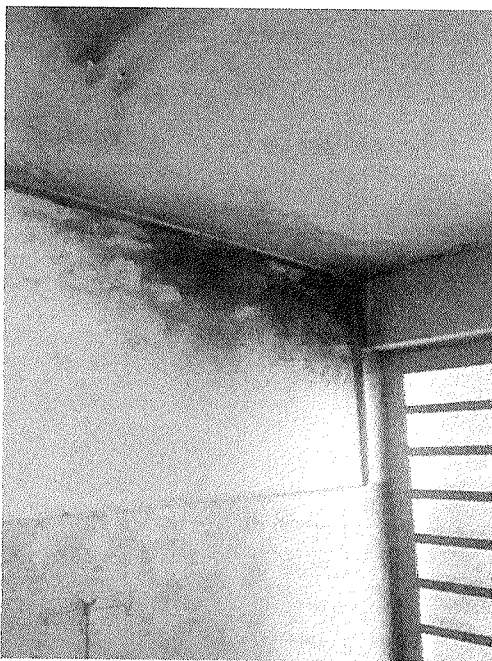
Figura 20 – Infiltração e mofo
