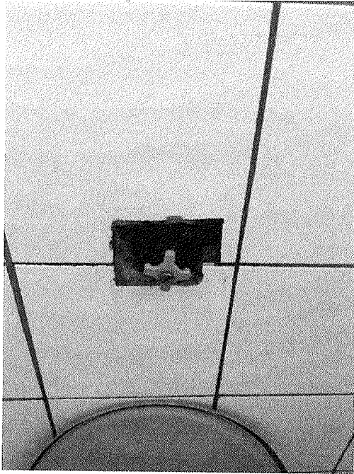
Figura 26 – Válvula sem acabamento.
