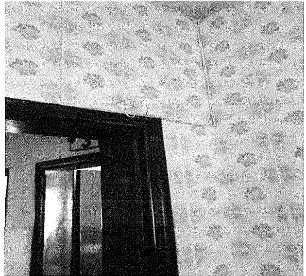
Figura 9 - Fiação exposta, refeitório
