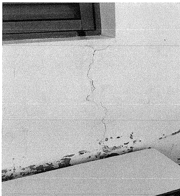
Figura 29 - Trinca, área externa
