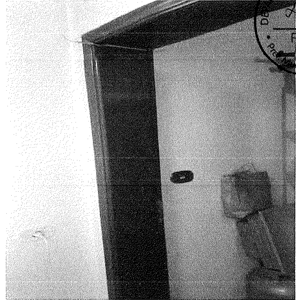
Figura 35 - Portal em mau estado de conservação
