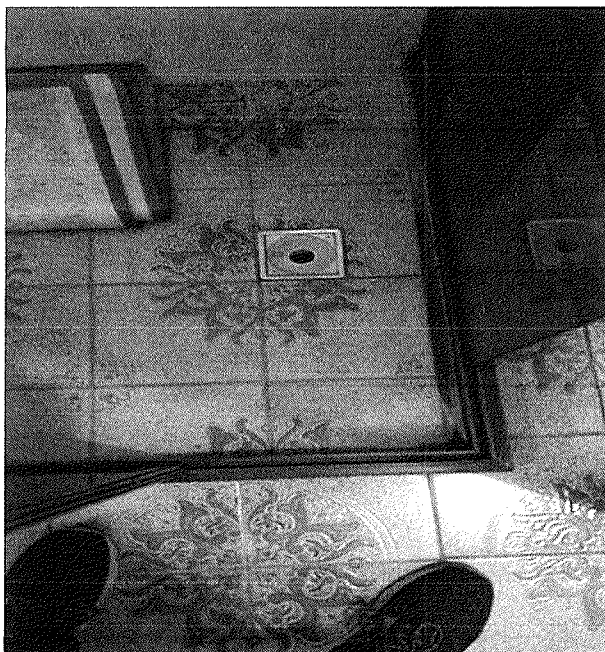
Figura 2 - Ausência de ralo, banheiro
