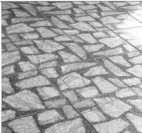
Figura 17 - Revestimento danificado, pátio
