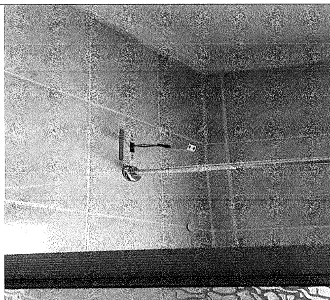
Figura 5 - Fiação exposta, banheiro 2
