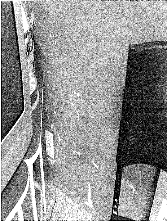
Figura 6 - Descascamento da pintura, sala 1
