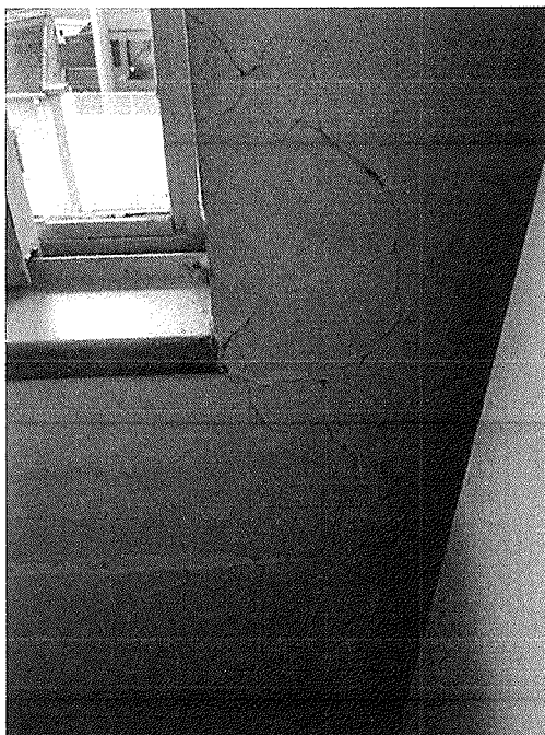
Figura 6 – Trincas na parede por falta de viga na sala do departamento administrativo
