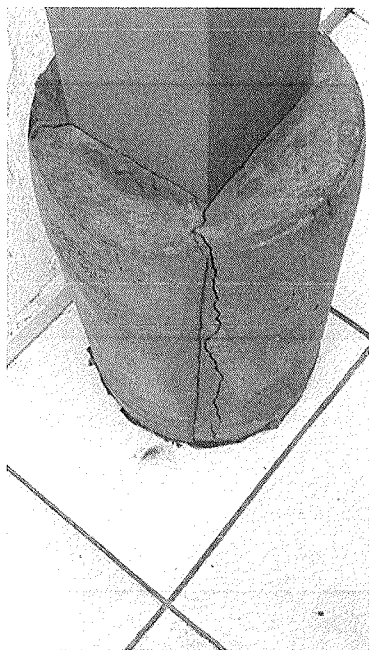
Figura 12 - Trincas no concreto no pilar. Patologia encontrada na maioria dos pilares do corredor
