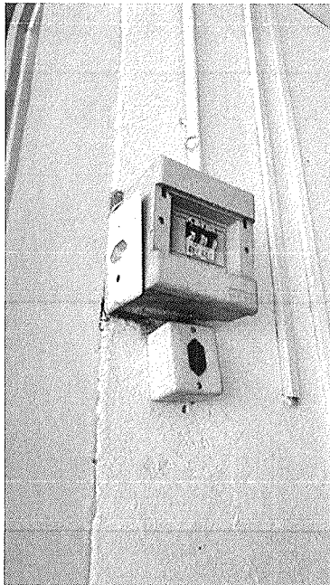
Figura 24 - Instalação elétrica inadequada
