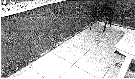
Figura 2 - Umidade e revestimento danificado, Sala de isolamento
