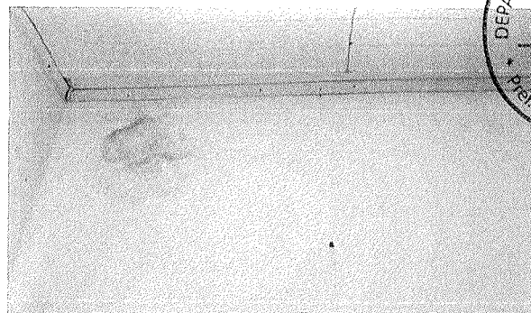
Figura 15 - Infiltração na parede, sala 9
