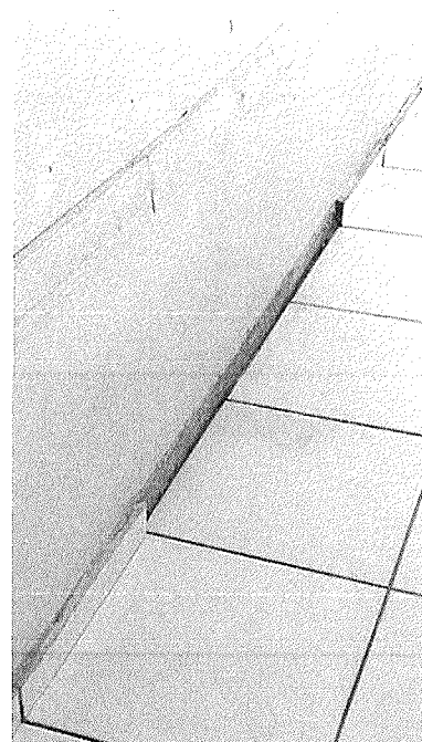
Figura 9 - Descolamento e revestimento cerâmico faltando no rodapé, sala de aula 5
