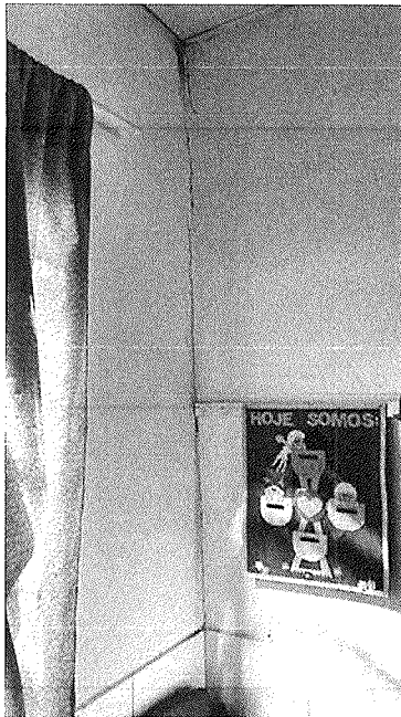
Figura 4 - Trinca na parede, sala de aula 1
