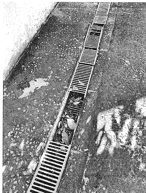
Figura 41 - Grelhas quebradas no fundo da escola
