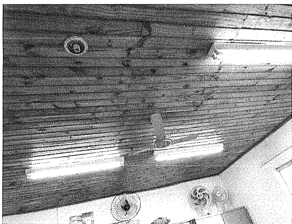
Figura 6 - Falta luminárias na sala de aula 2
