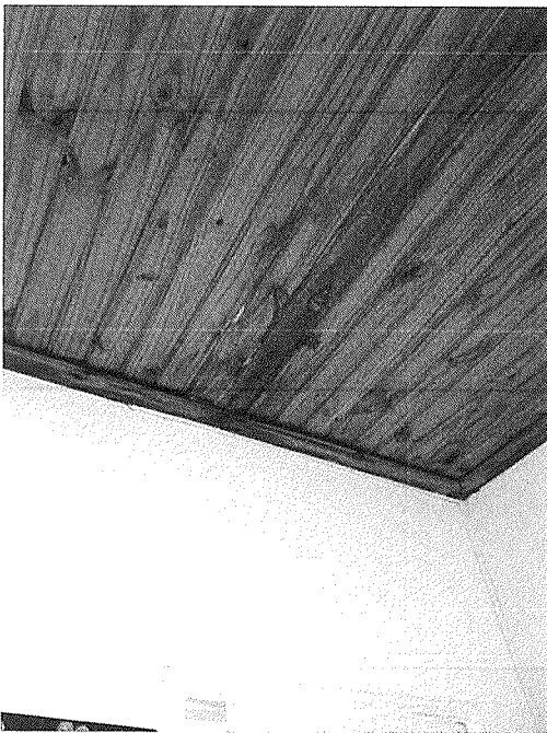
Figura 4 - Forro com defeito na sala dos professores
