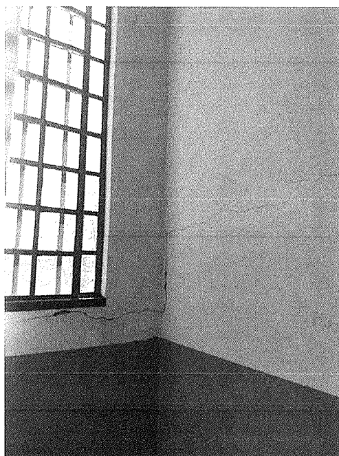
Figura 61 - Trinca entre as paredes
