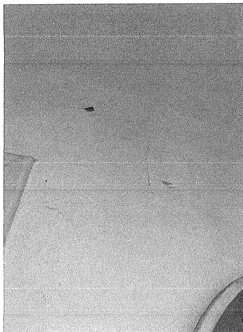
Figura 123 - Trincas na parede
