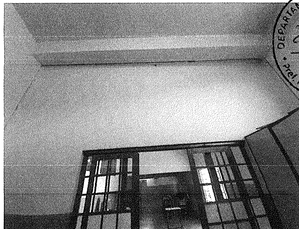
Figura 107 - Rachadura entre paredes e laje
