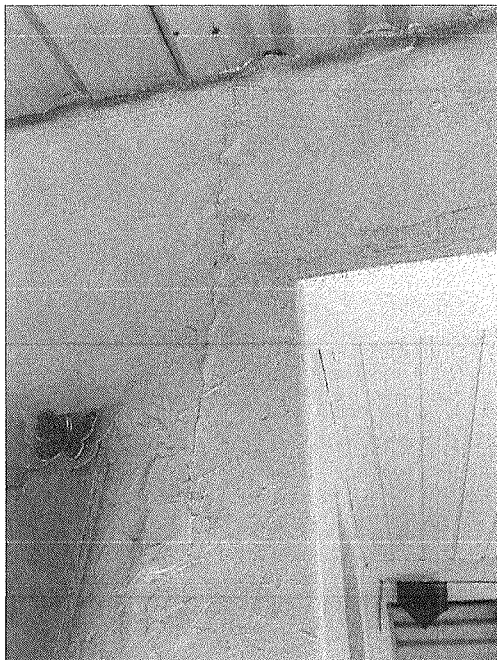
Figura 32 – Trincas nas paredes.
