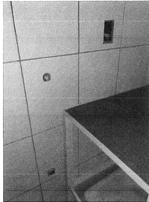
Figura 23 – Encanamento e caixa de tomada abertos.
