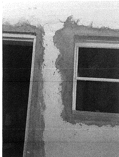
Figura 21 – Falta de pintura nas paredes.
