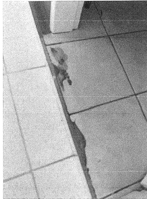
Figura 31 – Infiltração e revestimento danificado na biblioteca.
