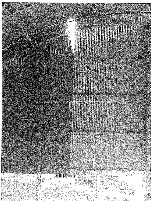
Figura 12 – Cobertura da quadra danificada.
