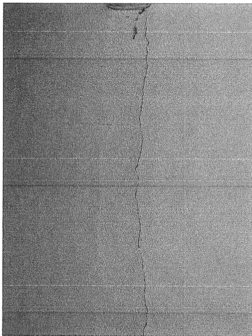
Figura 4 – Trincas em vários pontos da edificação.
