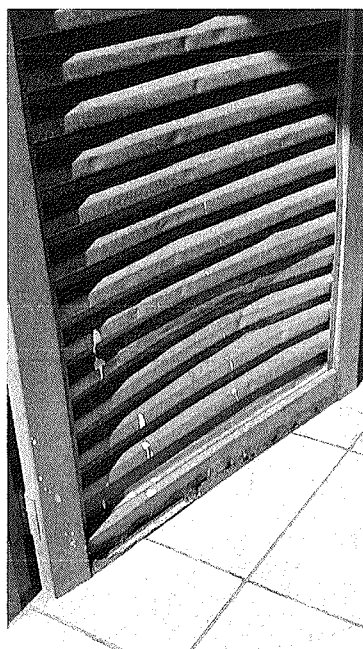
Figura 45 – Porta danificada no banheiro masculino da quadra.
