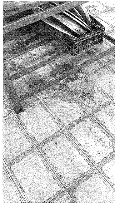
Figura 17 – Falta de revestimento cerâmico na cozinha.
