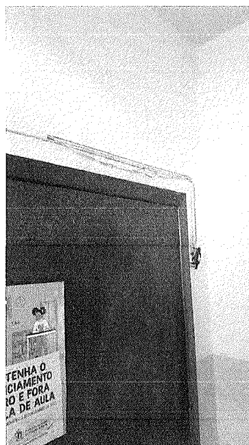
Figura 33 – Instalação elétrica provisória na sala 01.
