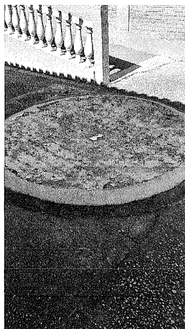
Figura 41 – Tampa do antigo aquário desnivelada no pátio da entrada.
