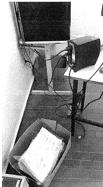
Figura 31 – Tomadas insuficientes na diretoria.
