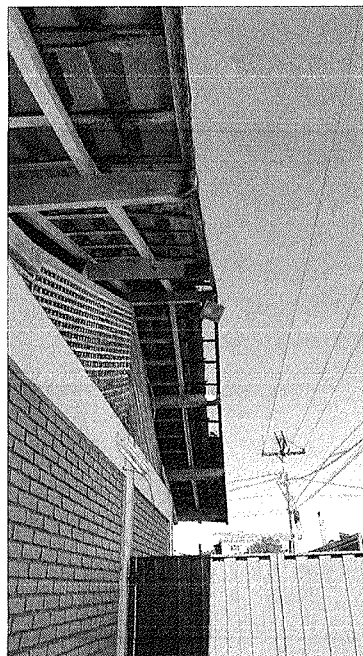
Figura 43 – Falta de telhas cerâmicas.
