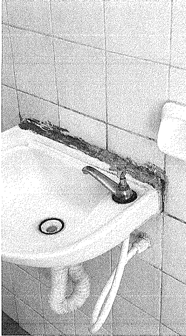
Figura 26 – Pia quebrada no banheiro feminino.
