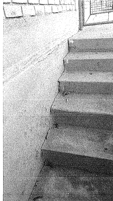
Figura 15 – Trincas entre parede e piso.
