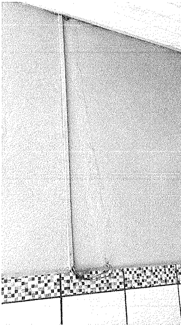
Figura 16 – Instalação elétrica provisória na cozinha.
