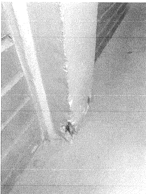
Figura 16 – Danos na base do pilar.
