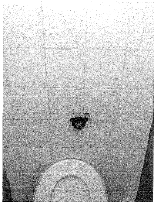
Figura 21 – Válvula sem acabamento.
