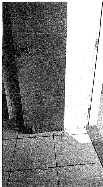
Figura 13 – Porta danificada na cozinha.
