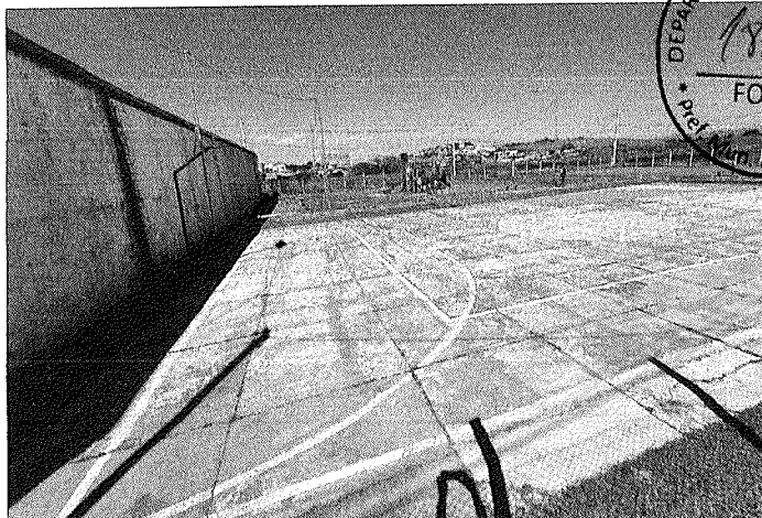
Figura 107 – Quadra com pintura danificada.
