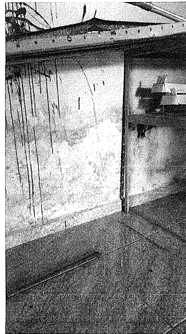
Figura 47 – Umidade no depósito.
