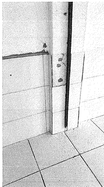
Figura 31 – Revestimento danificado no corredor.
