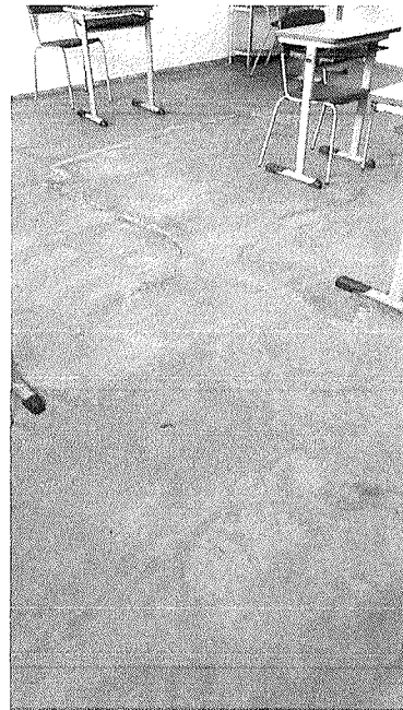
Figura 93 – Piso sem revestimento na sala 38.
