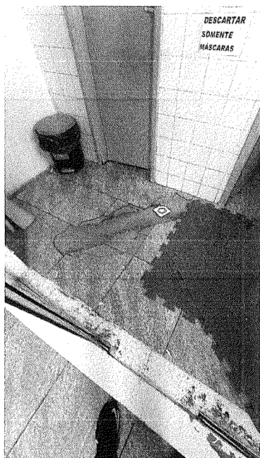
Figura 76 – Revestimento danificado no banheiro da sala 30.
