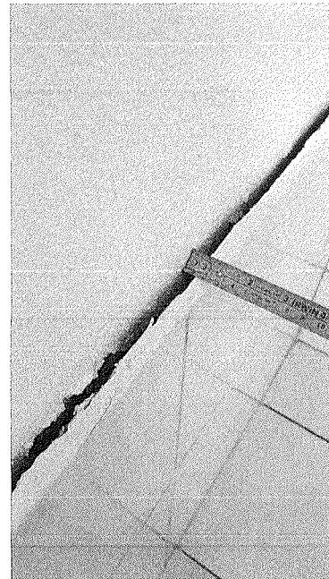
Figura 49 – Cerâmica descolando na sala 14.
