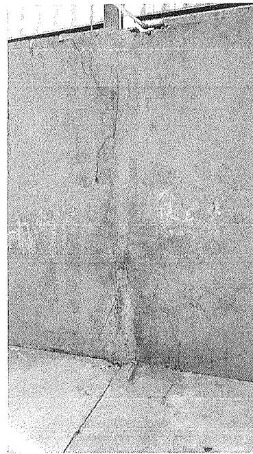
Figura 111 – Infiltração nas paredes da quadra.
