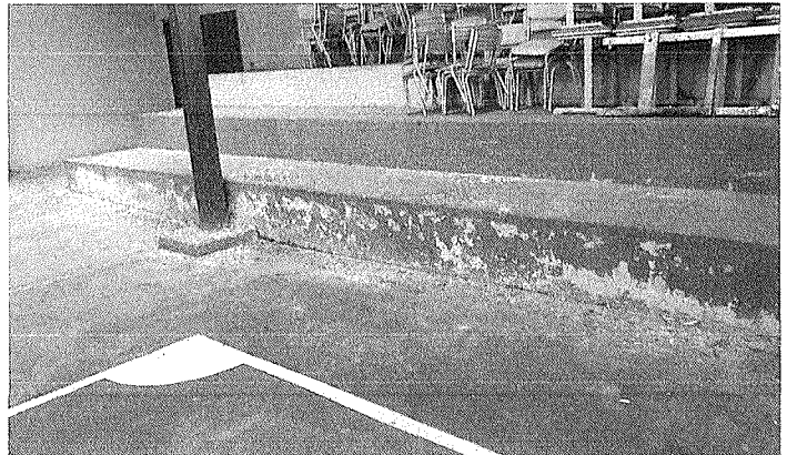
Figura 113 – Trincas nas arquibancadas.
