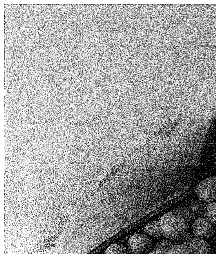
Figura 33 – Pontos de umidade na dispensa.
