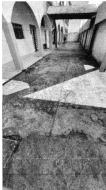
Figura 61 – Piso irregular e com rachaduras.
