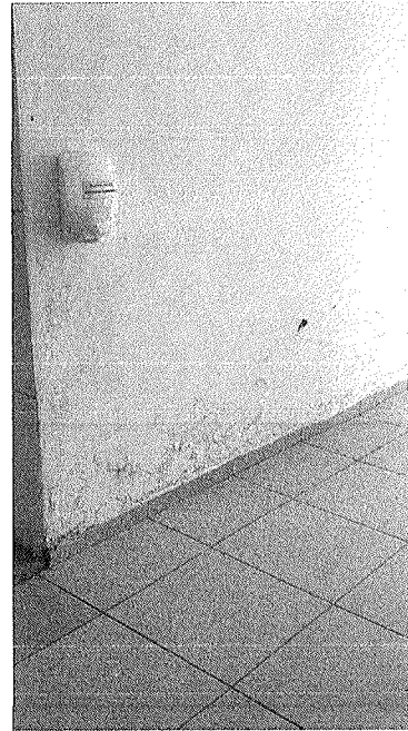
Figura 23 – Umidade na área externa.
