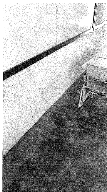
Figura 21 -Infiltração e trincas.
