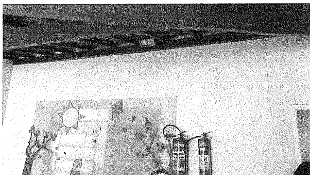
Figura 10 – Infiltração e danos no telhado.
