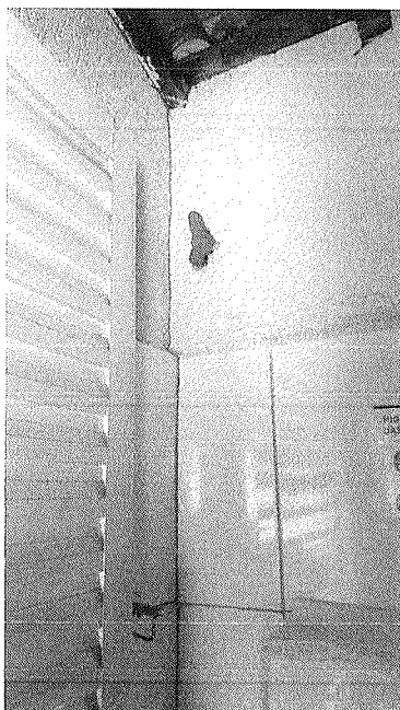
Figura 12 – Trinca no banheiro masculino.
