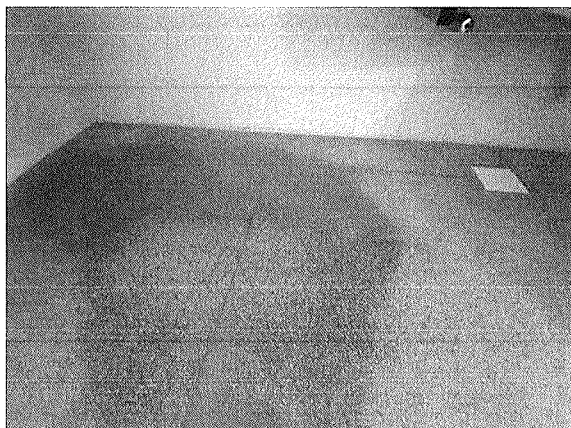
Figura 24 - Ralo entope periodicamente ocasionando infiltração no chão
