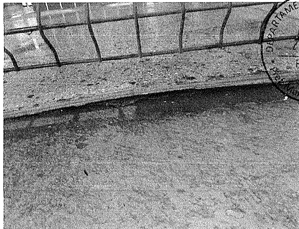
Figura 47 - Estufamento do piso por umidade
