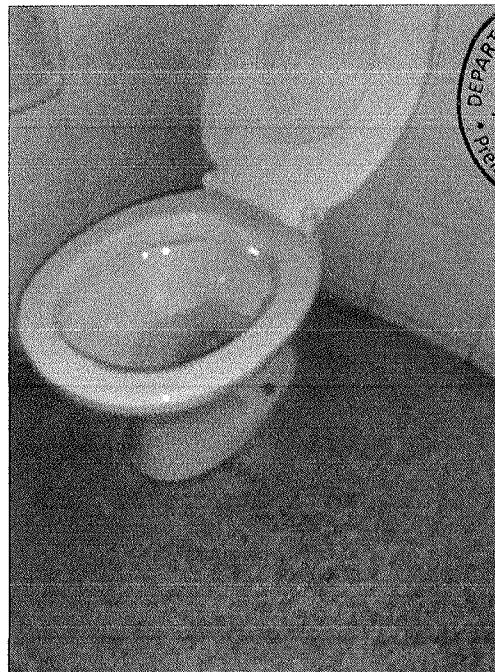
Figura 43 - Vazamento na bacia sanitária
