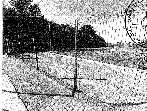
Figura 55 - Pontos da grade soltos
