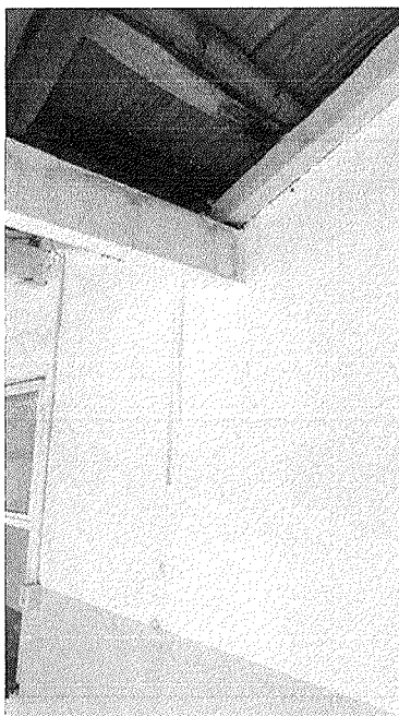
Figura 26 - Infiltração no telhado do pátio e tudo com defeito
