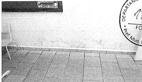
Figura 19 - Umidade por capilaridade na sala do maternal 2a
