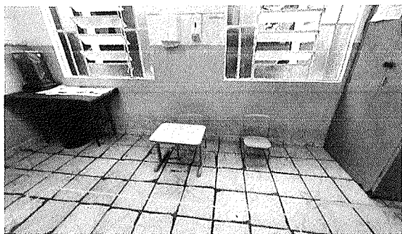
Figura 14 - Umidade por capilaridade na sala do maternal 1a
