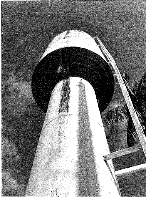
Figura 58 - Caixa d'água com ferrugem exposta
