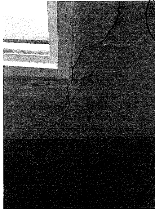
Figura 31 - Trinca na parede do maternal 2
