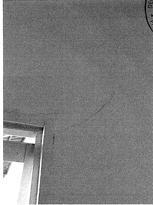
Figura 51 - Trinca por falta de verga no lactário
