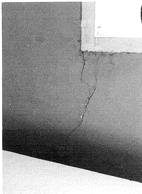
Figura 47 - Trinca na parede do berçário 2
