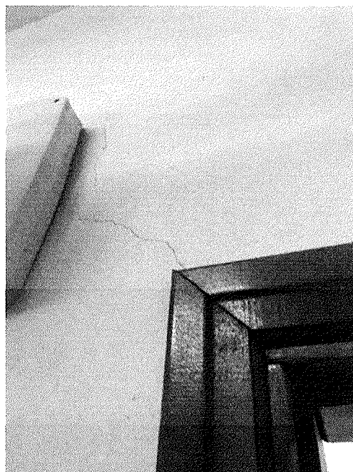
Figura 45 - Trinca na parede próximo à porta da lavanderia
