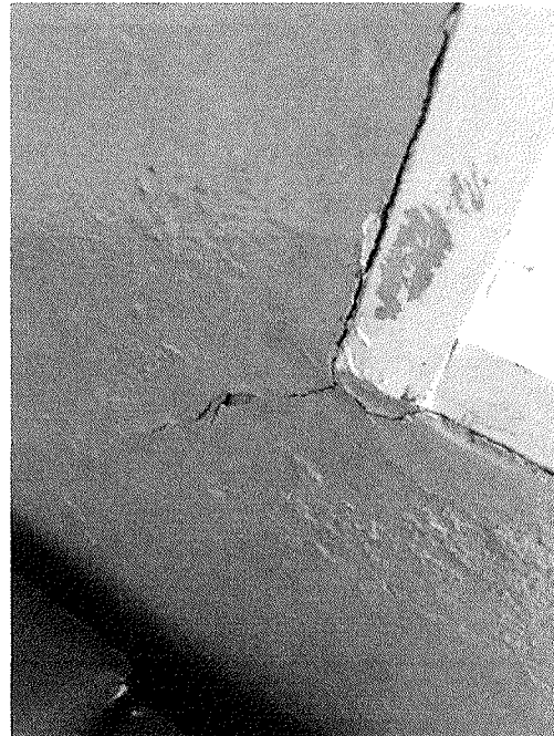
Figura 53 - Trinca na parede do maternal 1
