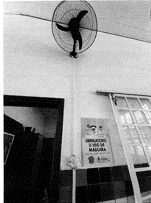
Figura 59 - Ventilador danificado do refeitório
