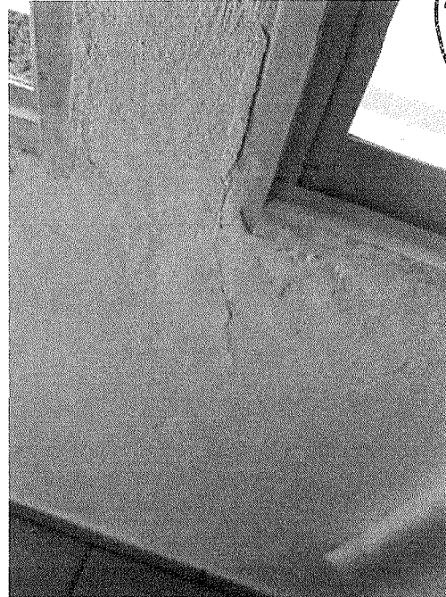
Figura 55 - Trinca na parede da brinquedoteca
