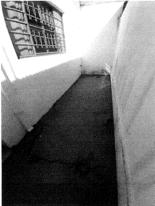
Figura 16 - Infiltrações e trincas na área externa da sala do maternal 1
