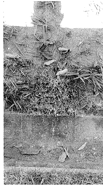
Figura 15 - Esgoto desce da escola CAIC
