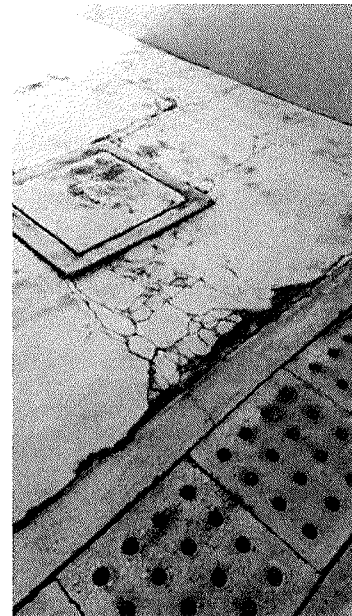
Figura 13 - Trincas no piso. Sala do berçário 3.
