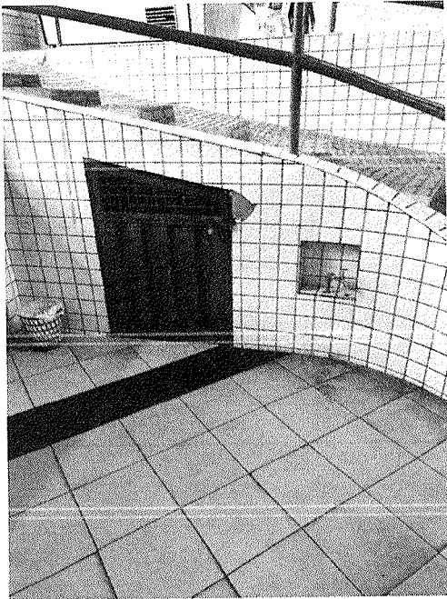
Figura 36 – Portão do depósito com ferrugem
