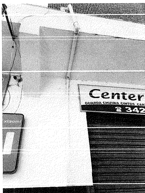
Figura 12 – Tubulação expostas do lado esquerdo
