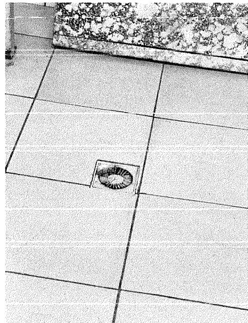
Figura 55 – Ralo quebrado na loja
