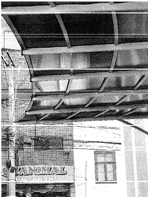
Figura 4 – Vedação solta na cobertura de policarbonato
