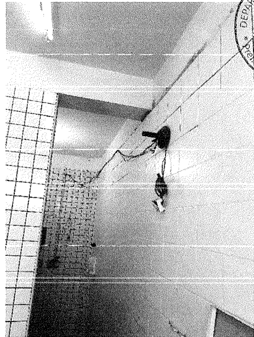
Figura 45 – Fiação expostas no banheiro feminino
