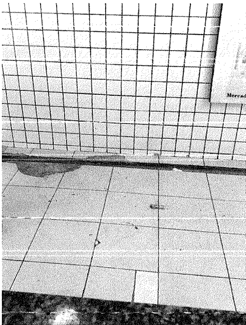
Figura 54 – Piso quebrado e rasgo no piso da loja 64
