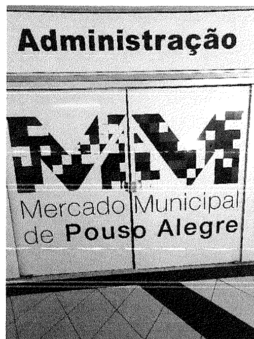
Figura 69 – Porta da sala de administração não esta fechando e está sem fechadura
